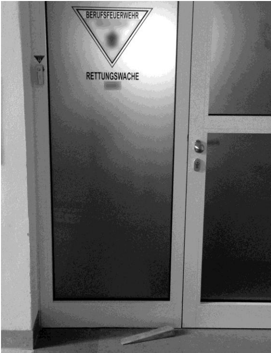
Holzkeil vor einer Rauchschutztür in einem Treppenhaus
